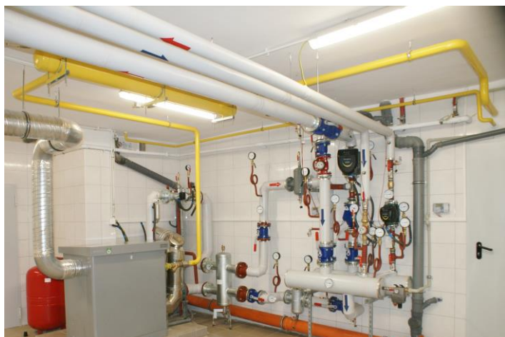
Zdjęcie Nr 6. Kotłownia gazowa w Zespole Szkół w Rudkach
