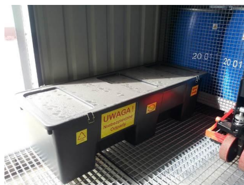
Fot. 10. Wyposażenie kontenera na odpady niebezpieczne – specjalistyczny pojemnik na zużyte świetlówki (fot. M. Jasiak).
