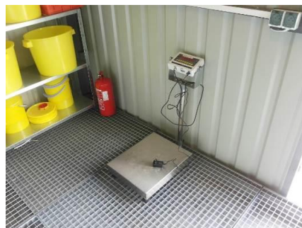
Fot. 6. Wyposażenie kontenera na odpady niebezpieczne - waga z zakresem ważenia do 150 kg.
