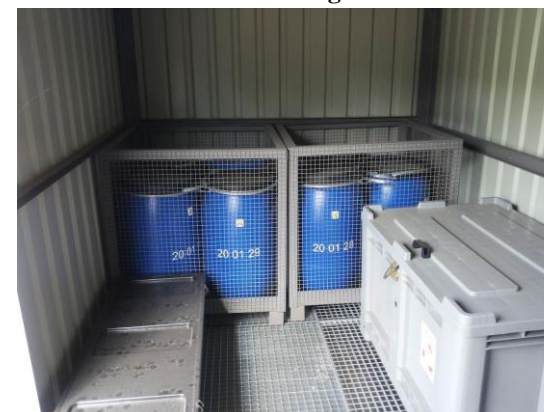
Fot. 8. Wyposażenie kontenera na odpady niebezpieczne – beczki do przechowywania płynnych substancji niebezpiecznych, stalowe kosze mogą służyć do przechowywania drobnego sprzętu elektrycznego i elektronicznego.
