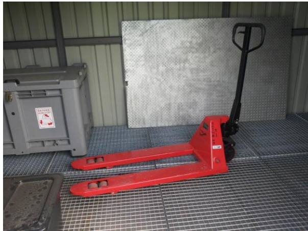
Fot. 11. Wyposażenie kontenera na odpady niebezpieczne – wózek ręczny paletowy „paleciak” z udźwigniem do 2 500 kg wraz z rampą najazdową.
